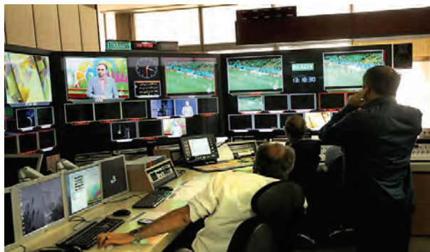
تصویر ۲۹- اتاق فرمان کنترل پخش
