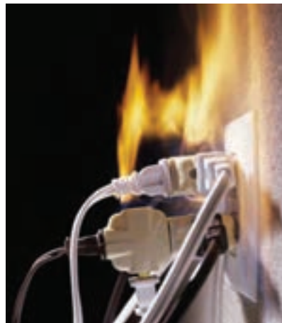
شکل ۹-۳ – آتش‌سوزی حاصل از ایجاد جرقه و سوختن سیم‌های برق
